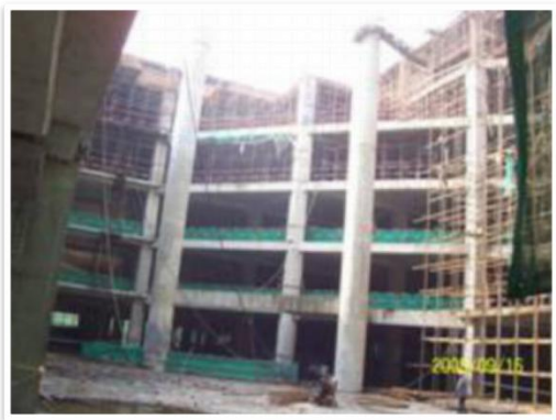
北京西西工程支撑体系坍塌事故
